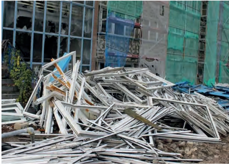
Рисунок 2 – Демонтовані віконні ПВХ профілі
